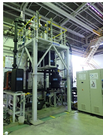
冷熱ORC実証試験設備外観
