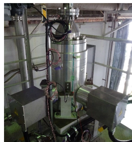
冷熱ORCタービン発電機外観
