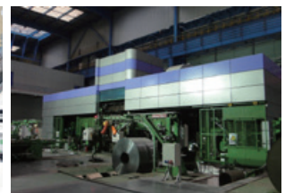
電磁鋼板生産設備
