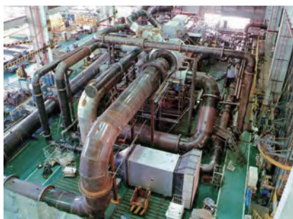
ギアドコンプレッサ(PTAプラント用)
