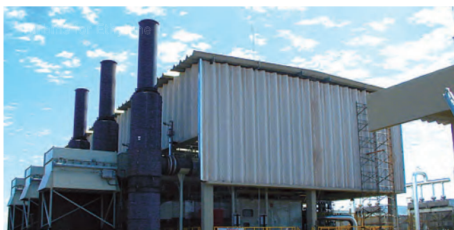
パイプラインステーション
