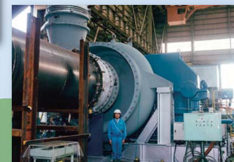
Компрессор газа и воздуха (комбинированный тип) для завода по производству стирола
