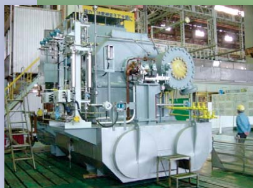
Компрессор топливного газа для электростанции
