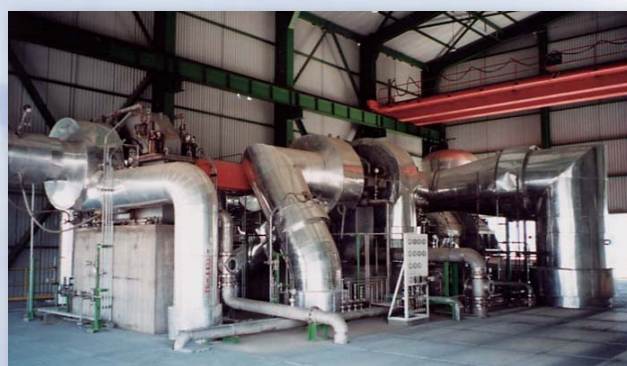
Воздушный компрессор и газовый экспандер для завода по производству очищенной терефталевой кислоты
