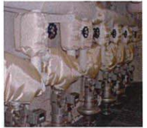
温度調節弁(3方弁)ポンプ室設置例
