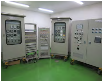
各種制御盤の製作・デバック
