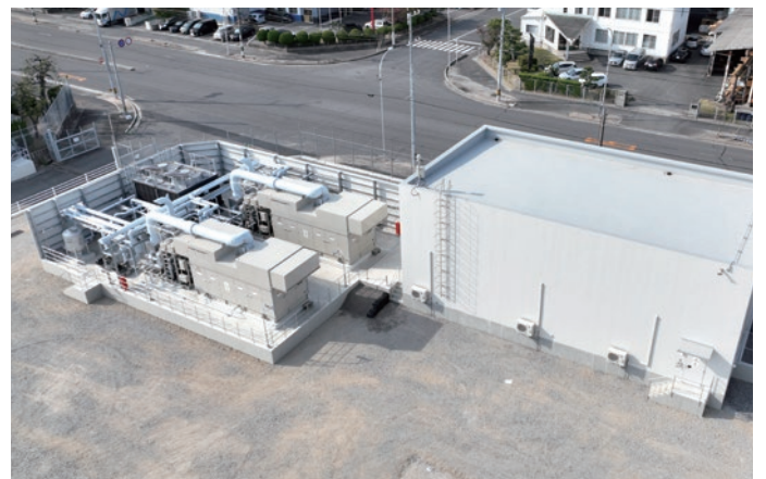
広島ガス株式会社 発電設備建設工事 ガスコージェネレーションシステム(ガスエンジン)1,000kW×2基 構造:RC造 階数:地上1階建 延べ面積:200㎡ 竣工:2023年
