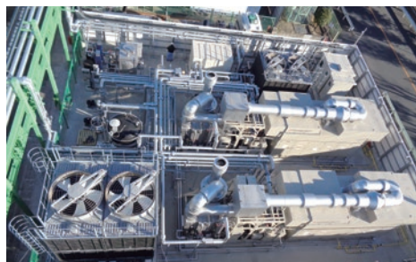
富双合成株式会社 コージェネレーション設備 竣工：2020年 1,000kW × 2基 (蒸気・温水回収、停電対応機能付)
