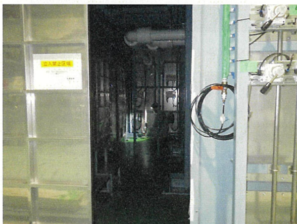
防護カバー内の照明スイッチ位置
