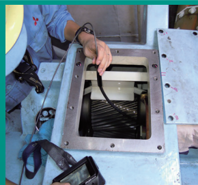
増速機点検の例
